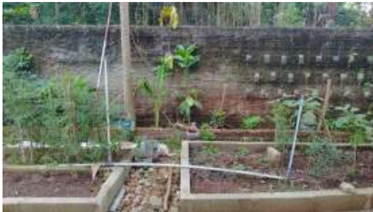
Gambar 8. Instalasi penyiraman disalah satu sudut
