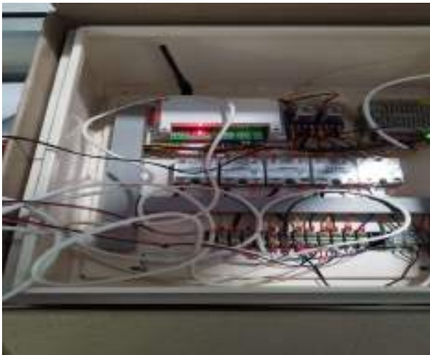
Gambar 6. Instalasi pada panel.
