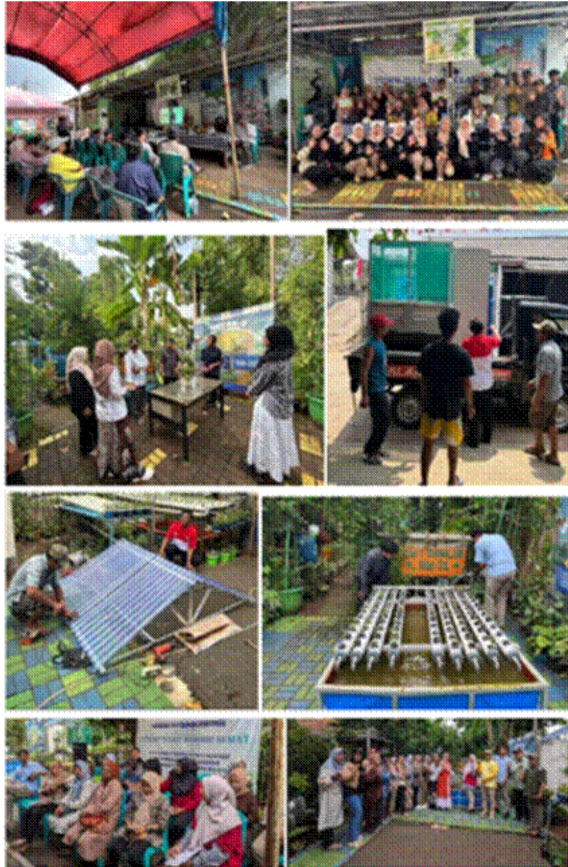
Gambar 4.3 Kegiatan pemasangan dan penggunaan infrastruktur hijau di Bank Sampah Dahlia Indah
